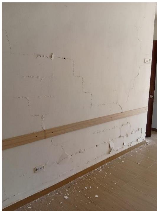
Ilustración 40. Falla de muro en mampostería
