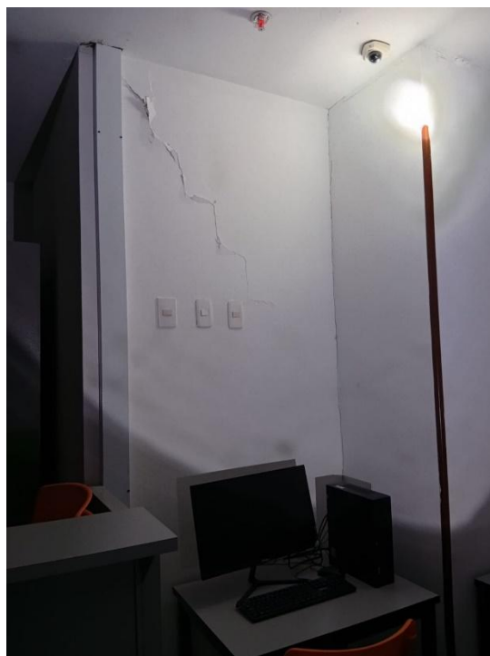
Ilustración 41. Falla muro en mampostería Biblioteca -INTENALCO - 10-08-2026
