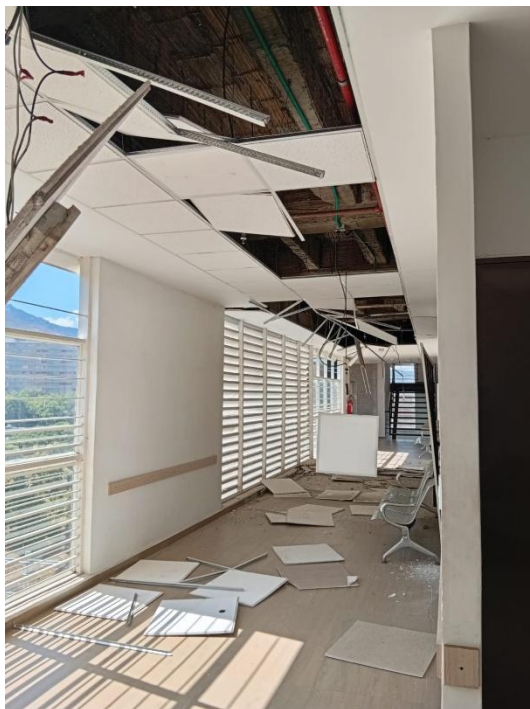
Ilustración 42. Cielo raso descolgado con estructura fallada, desanclaje - INTENALCO - 10-08-2026
