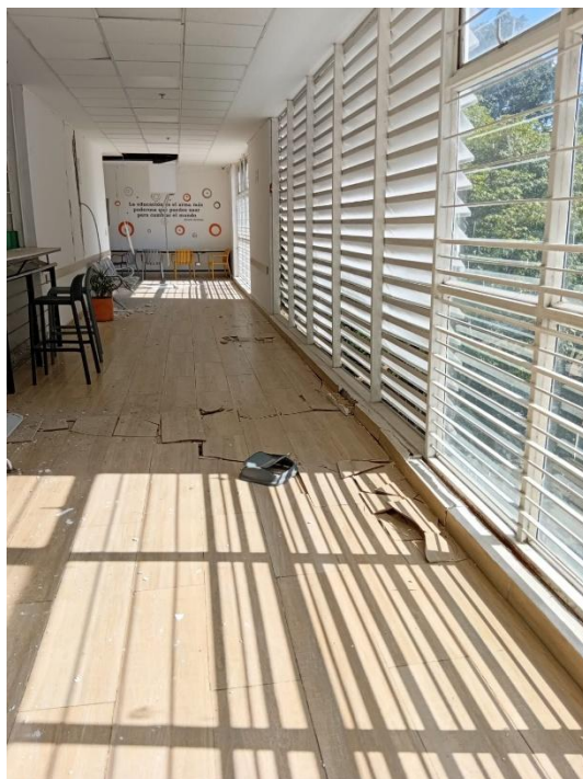
Ilustración 49. Desprendimiento estructura metálica arquitectónica piso 3 frente a fachada AV 4N – INTENALCO – 10-08-2026
