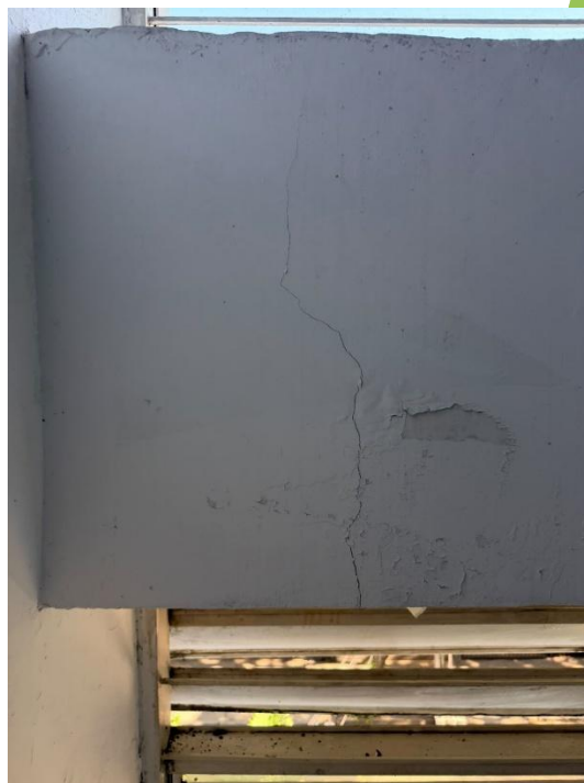
Ilustración 17. Fisura vertical en viga de 3er piso
