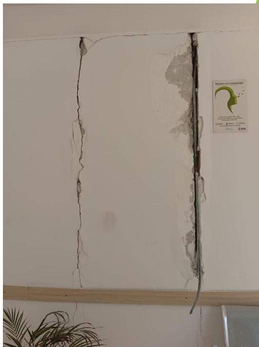
Ilustración 14. Columnas en piso 3 en interacción con muros divisorios de mampostería
