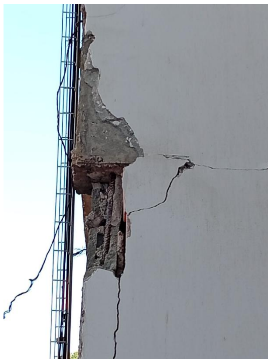
Ilustración 37. Muro en mampostería desprendido
